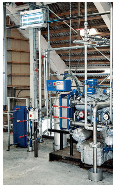
Et af de mange energispareprojekter på Scanola. Før blev procesvand opvarmet med damp, men nu opvarmes det med Scanolas færdige produkt, rapsolie, og det er langt mere energirigtigt.
